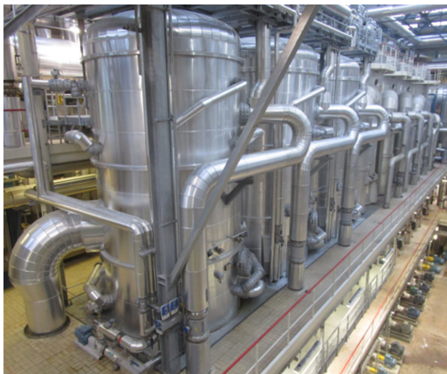
De nieuwe verdampingsinstallatie in Dinteloord is goed voor 14% energiebesparing
